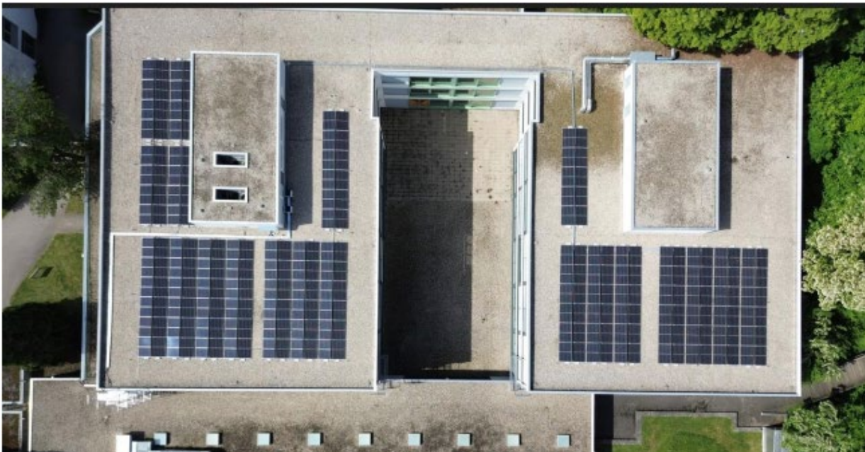
Abbildung 3: PV-Anlage auf dem Dach des Gebäudes B der Gottlieb-Daimler-Schule 2 in Sindelfingen
